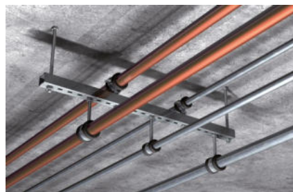
Instalacje sanitarne i przemysłowe
